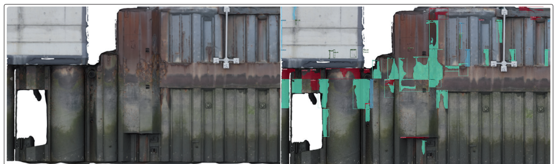
Abb. 6: Ergebnis der KI-basierten Schadensdetektion in Bilddaten
