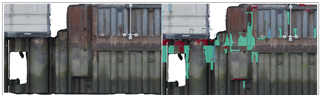
Abb. 6: Ergebnis der KI-basierten Schadensdetektion in Bilddaten
